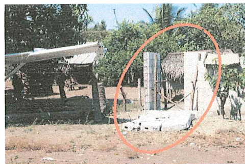
PARED DESTRUIDA POR GOLPE DEL ALA DERECHA.
