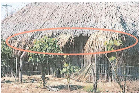
DAÑO AL TECHO DEL RANCHO CON EL ALA.
